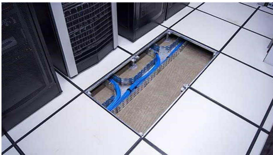
Figura 1- Cabeamento sobre piso elevado Convex Datacenter: Cabeamento estruturado, 2020.
